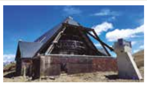
Inici de les obres en l'estació superior del telecabina de La Molina. Foto Daniel Busquets (2019).
