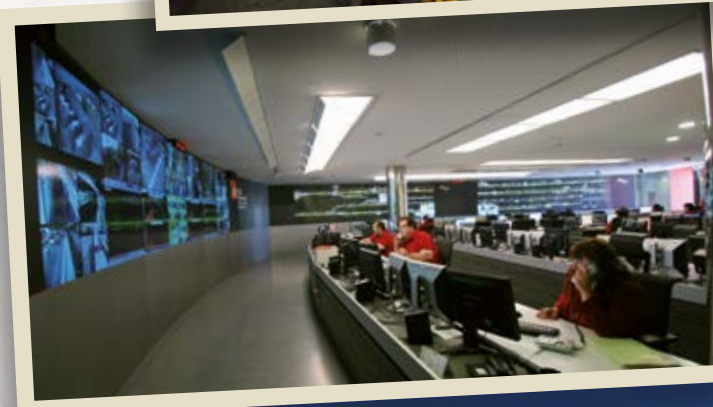
Des del COR de Rubí es controla la seguretat i les circulacions de tota la xarxa. Arxiu FGC (2013).
