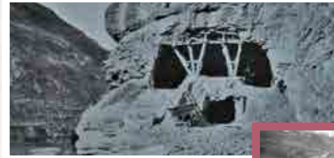
Construcció dels túnels entre La Puda i Monistrol sota el massís de Montserrat. Arxiu Salmerón (1921).
