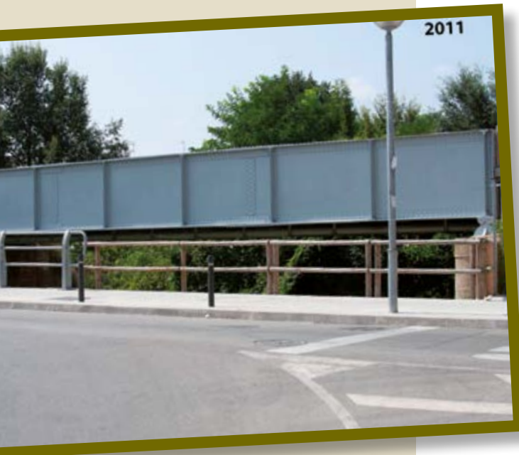
Pont sobre la Riera de Carbonell o de Corró. Únic element que queda del traçat original de la línia en el tram Granollers Centre a Les Franqueses. Lluís Garcia Rifà (2011).
