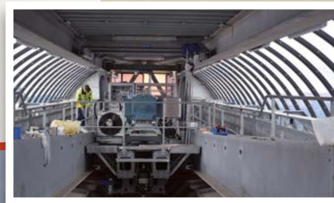
La maquinaria del nuevo telecabina se encuentra en la estación superior. Foto Joan C. Salmerón (2019).
