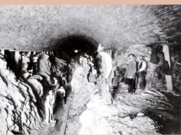
Diferentes imágenes de la construcción de la nueva línea entre Sarrià y Les Planes. La construcción del túnel bajo Vallvidrera, la nueva estación Peu del Funicular y las obras de los nuevos puentes y túneles. Archivo FGC (1914-15).
